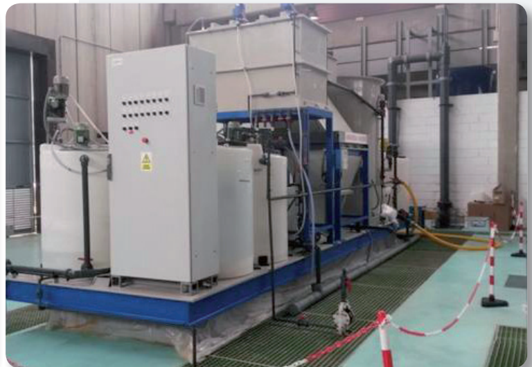
Figura 2b). Planta piloto de ZLD. | Figure 2b). ZLD pilot plant.
